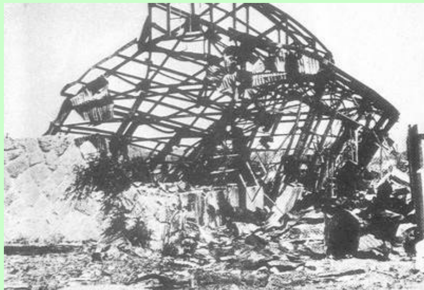
倒塌的钢架结构建筑物
